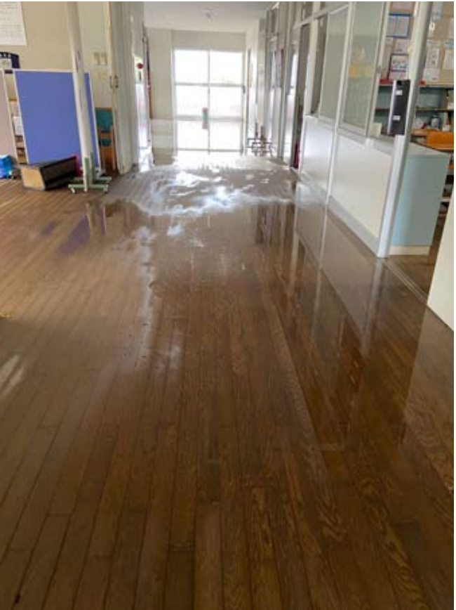
廊下も水浸しに
