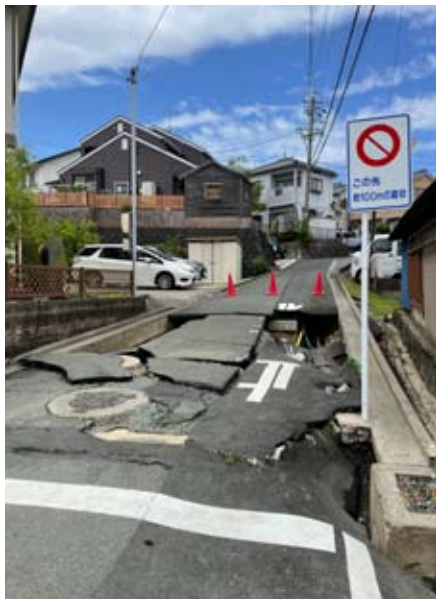
下長山町では道路が陥没した
