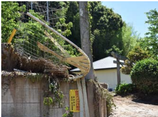
御津町金野地区で土砂崩れが発生
