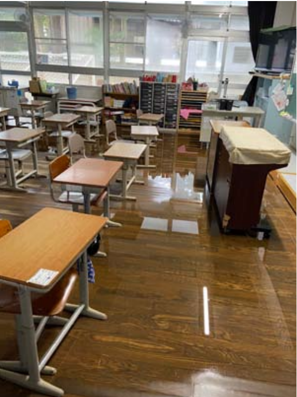
南校舎の教室では床が浸水
