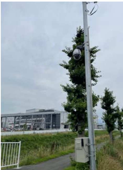
白川に設置された監視カメラ。後方はイオンモール豊川→
