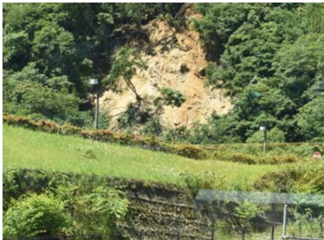
東三河ふると公園でも崩落
